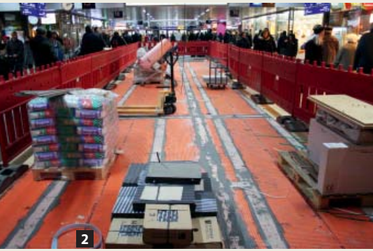
2 Die Erneuerung des Bodenbelags im Düsseldorf Hauptbahnhof wird während des laufenden Betriebs vorgenommen.
