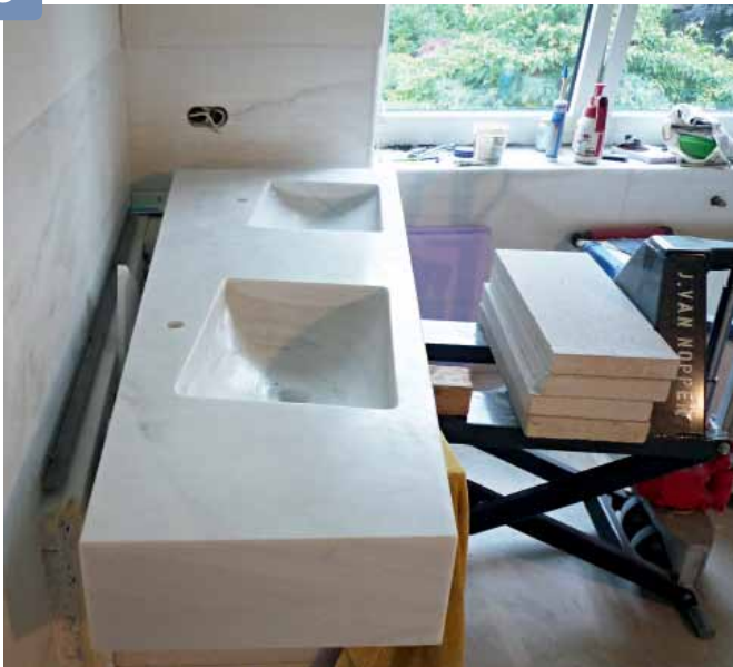
Mit dem Hubwagen wird das 420 kg schwere Werkstück in Position gebracht und montiert.
