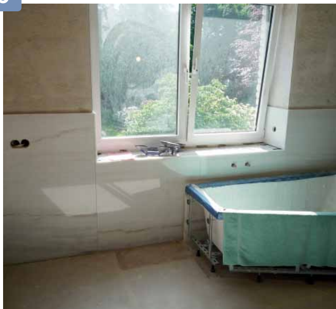
Der Bodenbelag ist bis unter die aufgestellte Wanne gezogen, um Anschnitte an den Platten zu vermeiden.
