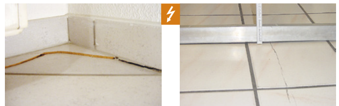
Typische Schäden bei konventionellen Heizestrichen
