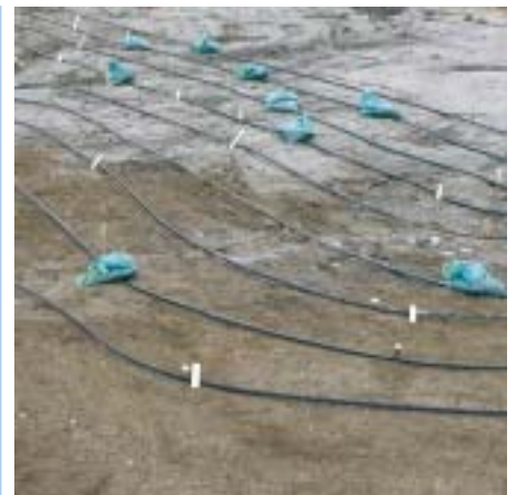
In circa einem Meter Tiefe wurden horizontal Rohre als Flächenkollektor verlegt, durch die eine frostsichere Soleflüssigkeit gepumpt wird.
