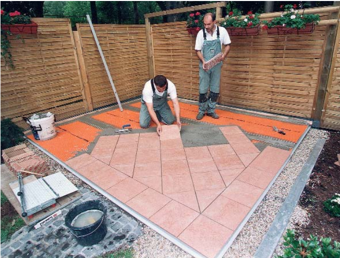
Die Verlegung der Feinsteinzeugkeramik auf der Entkopplungsmatte Schlüter-Ditra erfolgte schnell und einfach im Diagonalverbund mit CM-24-Mittelbettkleber Easyflex von Ceresit.
