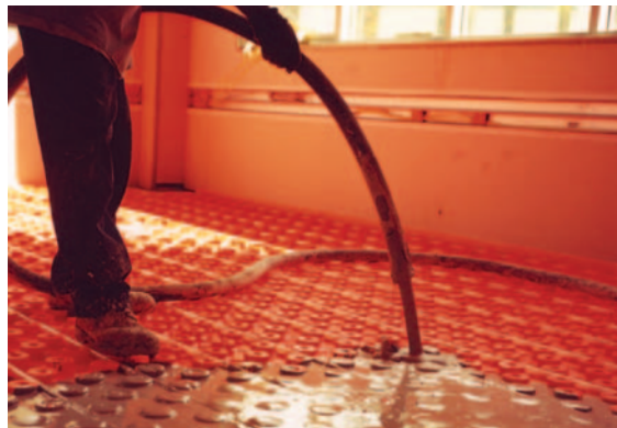
In dem Schlüter-Verwaltungsgebäude in Plattsburgh wurde überwiegend Anhydritestrich AE 20 eingebracht. Dank der zum System gehörenden Entkoppelungsmatte konnte schon ab einer Restfeuchte von 2 Prozent darauf weitergearbeitet werden.
