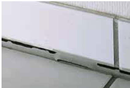
Das sollte vermieden werden – Schäden an der Fuge sehen nicht nur hässlich aus, sondern bieten auch Nährboden für Mikroorganismen.
