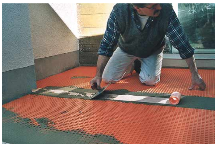
Durch Abdichten der Bahnenstöße und Randbereiche entsteht eine Abdichtung im Verbund mit dem Fliesenbelag.
