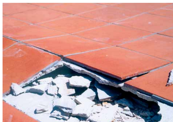
Längenveränderungen durch Schwindung und Temperaturwechsel führten hier dazu, dass sich der Belag vom Untergrund ablöste, weil er nicht entkoppelt wurde.
