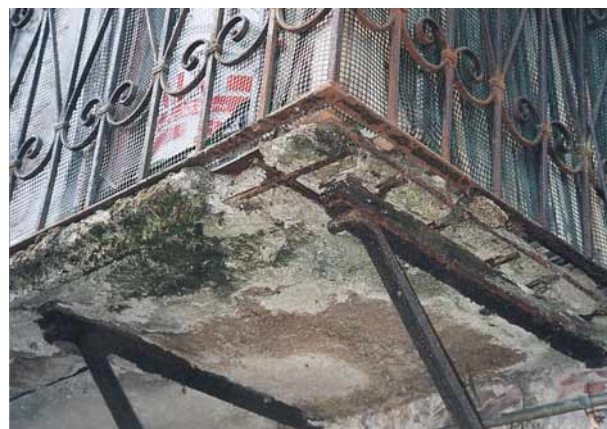
Wenn Wasser in die Konstruktion eindringt, ändert sich der pH-Wert des Betons. Der Armierungsstahl korrodiert und sprengt Teile aus der Kragplatte.
