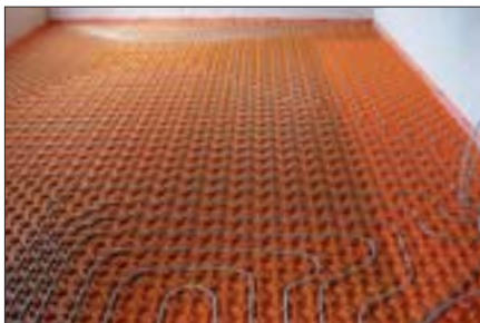
7. Nach \geq 2 Tagen* Trocknungszeit kann Schlüter®-BEKOTEC-THERM verlegt werden (*Je nach Temperatur und Einbaudicke).
