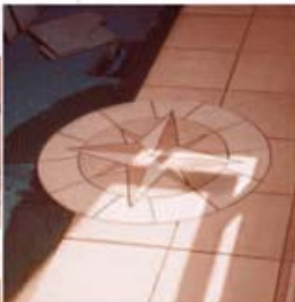
11 Ornamente, hier eine Windrose, zuerst legen. Die restliche Balkonfläche drum herum verfliesen.
