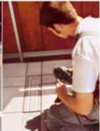
9 Abschlussprofile für die Sockelfliesen ablängen. An Ecken mit Gehungsschnitt in Form bringen.
