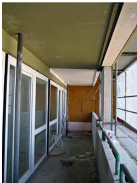
Ein Balkon sowie ein Laubengang des Neuen Forums Altona vor der Installation des Systemaufbaus und der anschließenden Verlegung der Feinsteinzeugplatten
