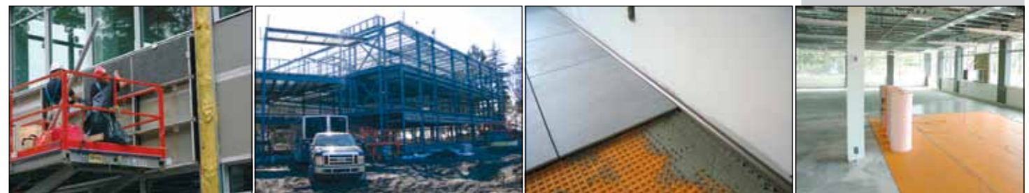
Fotos unten links: Das Gebäude wurde in Stahlbauweise errichtet, die Ausfachung erfolgte mit Sandwich-Dämmpaneelen. Die Fliesen werden im Dünnbettverfahren auf Entkoppelungsmatten verlegt, die für dauerhaft rißfreie Bodenbeläge sorgen (rechts)
