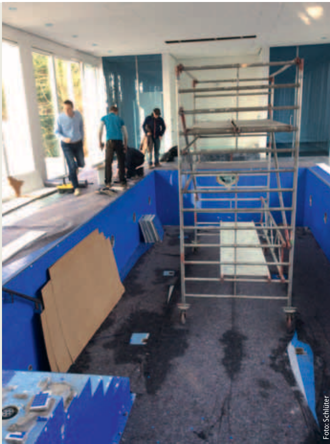
Alter Fliesenbelag im Becken
