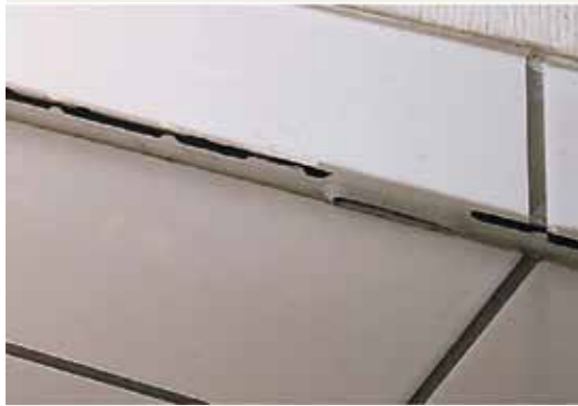
Schadhafte, gerissene oder mit Schimmel befallene Fugen lassen sich durch den Einsatz von Profilen wirksam verhindern.
