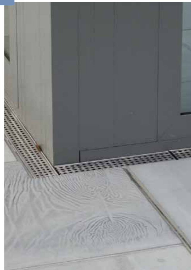
Bewegungsfugenprofil und Drainagerinne in Edelstahlausführung harmonisieren farblich unauffällig mit den dezenten Kalksteinplatten.
