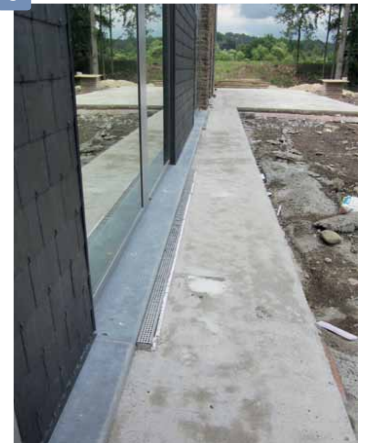
Am Übergang von innen nach außen führt eine 25 m lange Drainagerinne das Regenwasser zuverlässig ab.
