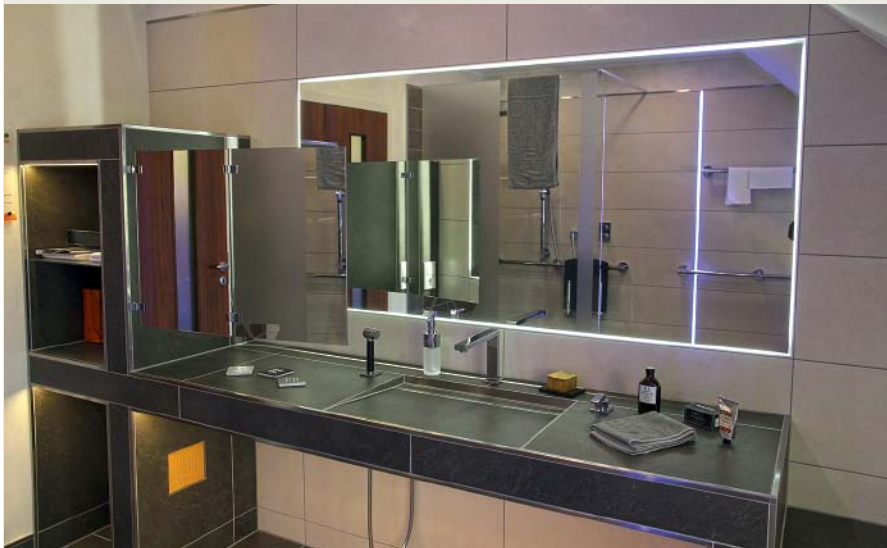
5 Der unterfahrbare Waschtisch sowie das daran anschließende Regal wurden komplett aus dem Fliesen-Verlegeuntergrund „Kerdi-Board“ erstellt und anschließend mit Fliesen beklebt.
