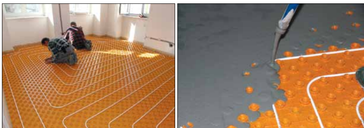
Die Heizrohre werden entsprechend der Vorgaben in die Noppen gedrückt und anschließend mit einem Fließestrich überdeckt.
