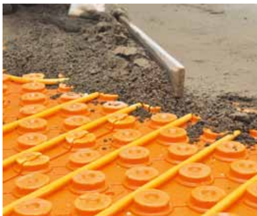
Der eingebrachte Estrich muss die Noppen der Systemplatte um lediglich mindestens 8 mm überdecken.
