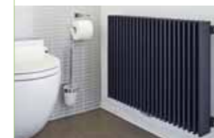
Heizkörper Damit es die Gäste stets schön warm haben, sorgt der Designheizkörper „Sky“ im Winter für angenehme Temperaturen. Er passt gut zu den grau glänzenden Keramikfliesen und der weiß verputzten Wand.
