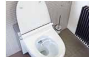
Dusch-WC Der Raum ist mit dem Dusch-WC „Sensia“ ausgestattet. Per Touchscreen-Fernbedienung lassen sich vier individuelle Duschprofile abspeichern. Wassertemperatur, Strahlstärke, Strahlpositionierung, Duschdauer und Wärme des Lufttrockners können eingestellt werden.
